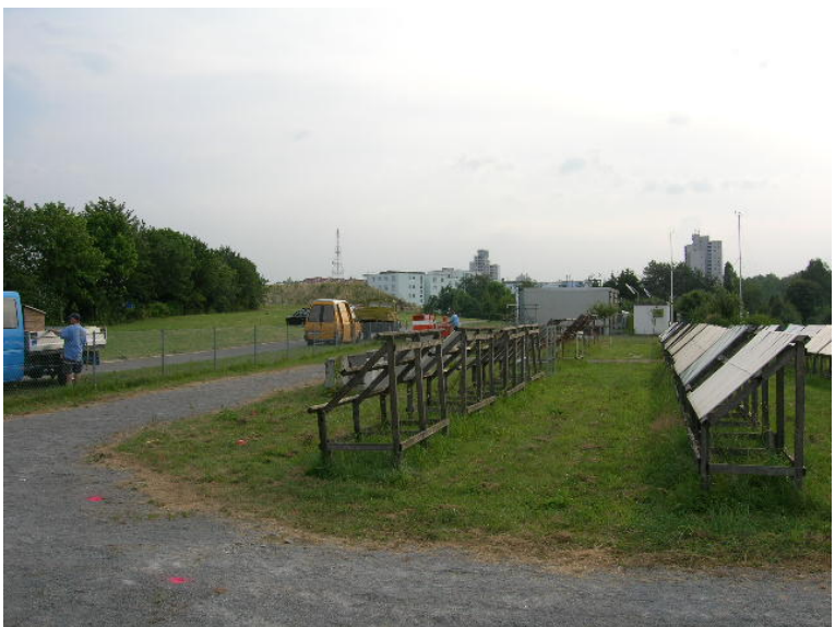
Abb. 14. Das Testfeld nach dem Verlegen der Erdwärmesonden. An der Oberfläche erinnern nur rote Sprühmarkierungen an den unterirdischen Verlauf der Sonden. Fig. 14. The test site after finishing the drilling works. Only red dots on the surface remember to the sond laying.
