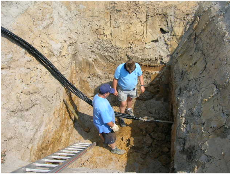
Abb. 12. Der Bohrkopf wurde gegen einen Aufweitkopf getauscht. Hinter dem Aufweitkopf werden 2 Doppel-U-Sondenleitungen ins Bohrloch eingezogen Fig. 12. The drill head became changed by a reaming head for enlarging the drill hole and for pulling in the horizontal geothermal sonds.
