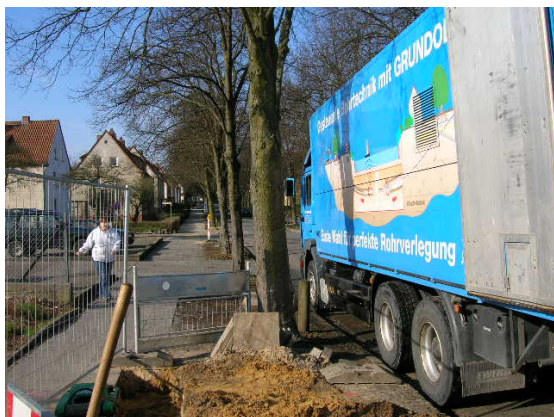
Abb. 6. Altkabelaustauschprojekt in Uelzen. Die Kabeltrasse befindet sich unter der Baumallee. Fig. 6. Project of replacement of old cables in Velzene. The Path of the cable is under the alley of trees.
