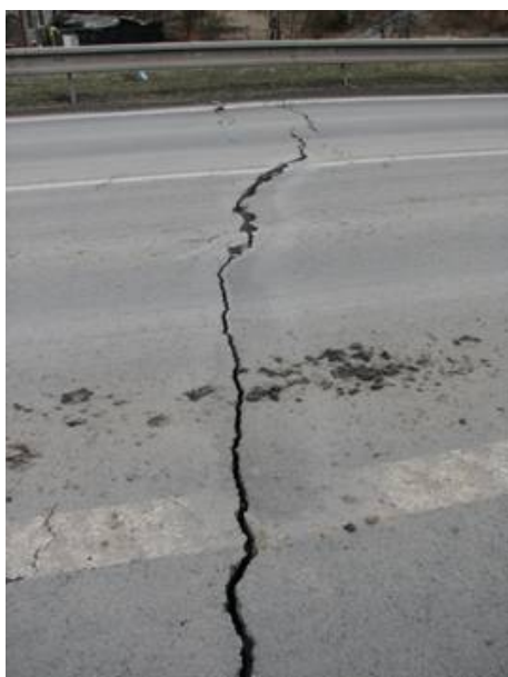
Obr. 7. Příčná trhlina ve vozovce. Fig. 7. Transversal crack in the road.
