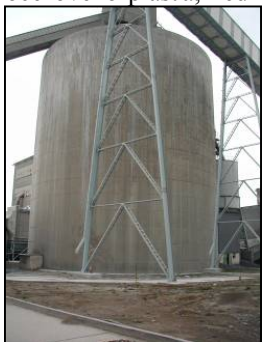
Obr. 1. Slinkové silo. Fig. 1. Clinker Silo.
