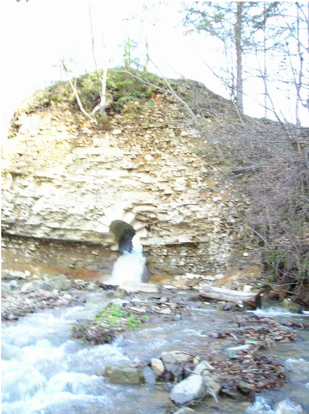
Obr. 2. Pohľad na porušenú kamennú murovanú priehradu v Zlatej Bani s dnovým výpustom zo vzdušnej strany ( máj 2005). Fig. 2. View on the broken dam built from a rock in Zlatá Baňa from air dry slope (May 2005).
