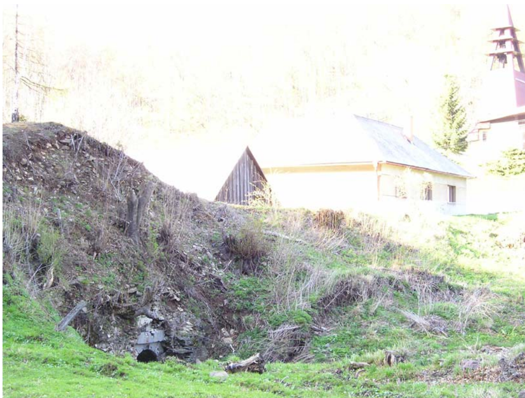
Obr. 5. Pohľad na návodný svah porušenej kamennej murovanej priehrady s čelom dnového výpustu v Zlatej Bani a najbližšie okolie. Fig. 5. View on the wet slope of the broken dam built from a rock with the brow of bottom outlet in Zlatá Baňa and the nearest surrounding.
