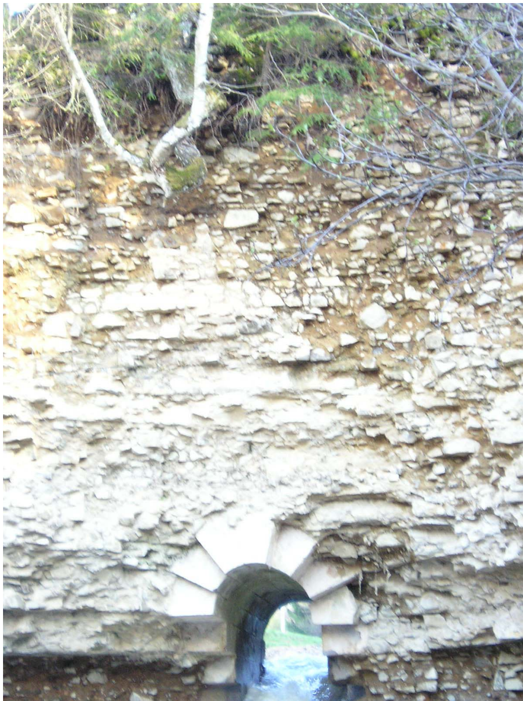
Obr. 3. Detailný pohľad na porušenú kamennú murovanú priehradu v Zlatej Bani s dnovým výpustom, zo vzdušnej strany (máj 2005). Fig. 3. Detail view on the broken dam built from a rock in Zlatá Baňa with the bottom outlet from air dry slope (May 2005).
