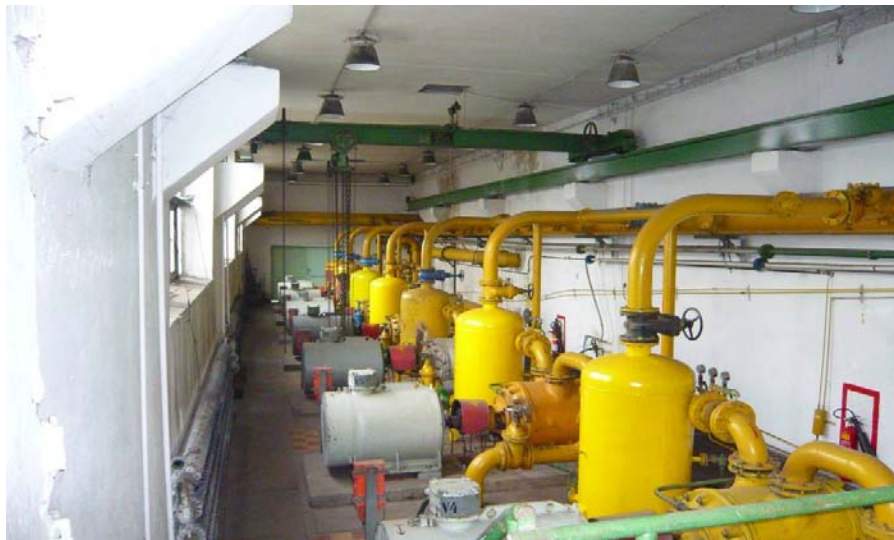
Fig. 4. Staříč degasification plant.
